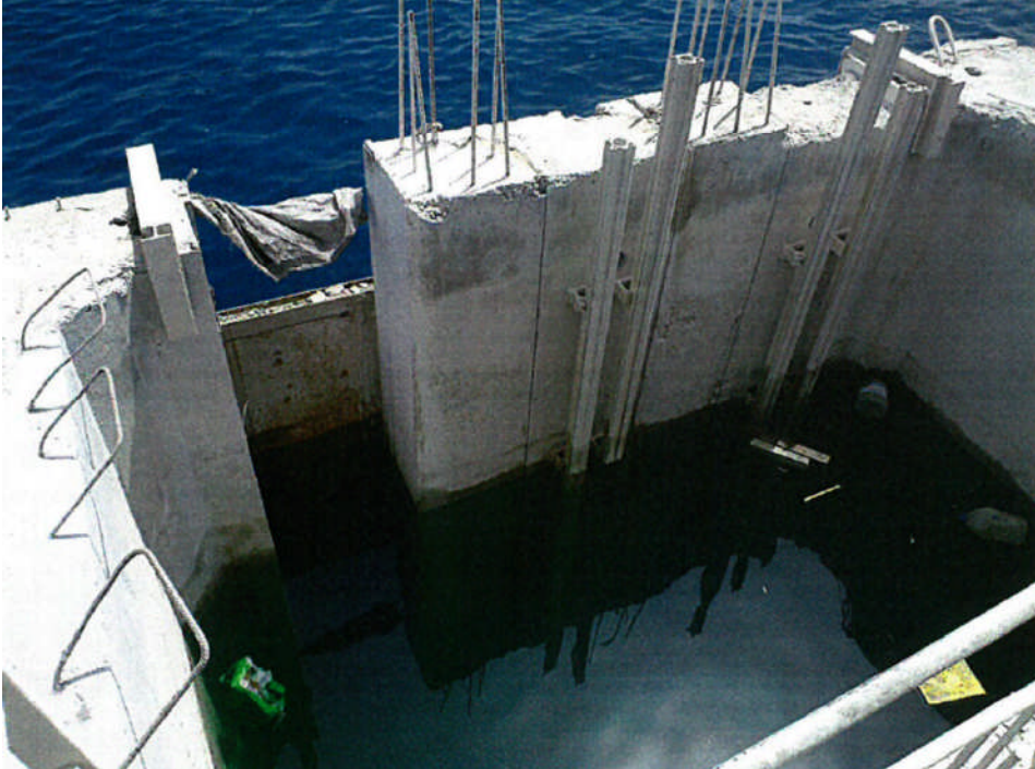
Imagen 3. Casetón donde ocurrió el accidente. Se observa el hueco dejado por el bloque de hormigón que causó la muerte del trabajador y las guías de aluminio por donde se movía el cabezal de la máquina cortapuros. El casetón no estaba cubierto de agua el día del cuando ocurrió el suceso dado que se achicaba el agua. También se observa la pantalla metálica que se colocaba para disminuir los efectos de los golpes de mar en el casetón donde se trabajaba.
