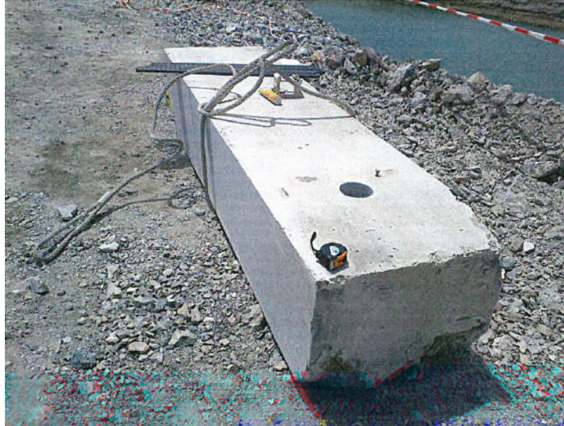
Imagen 4. Uno de los trozos del bloque de hormigón que se desplomó dentro del casetón
